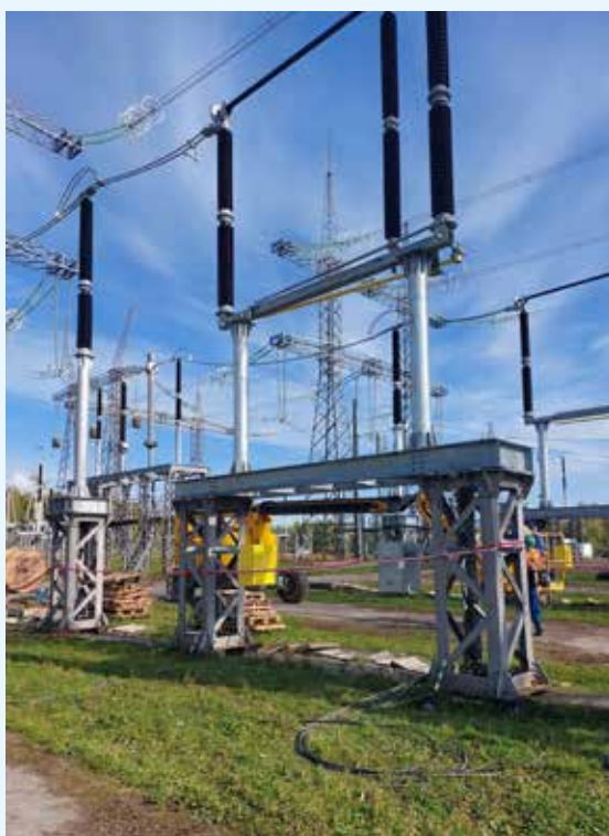
Fragment zmodernizowanej rozdzielni
